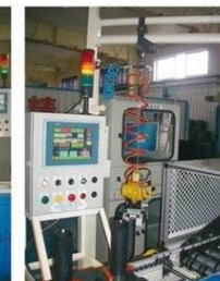
Unloading Station 完成品出料站
